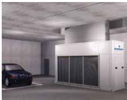
Liebert HPC-R внутри гаража
